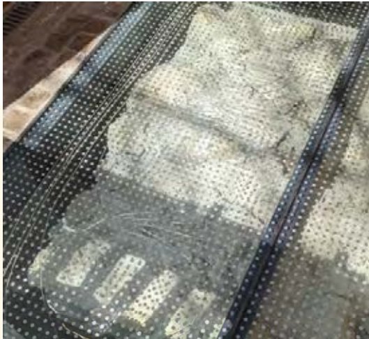
Vandalismus am Eingang zum Schlossstadel
