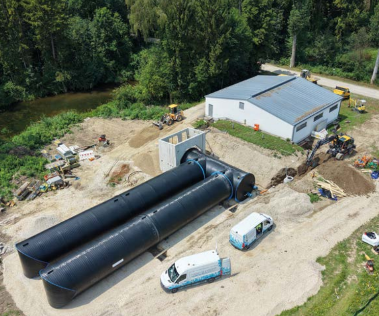
Die neuen Wasserkammern schaffen zusätzliche Speicherkapazitäten für die Trinkwasserversorgung.
