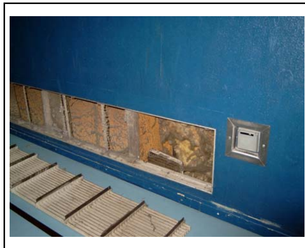
Bild 46: Abluftkanal der Turnhalle 1
