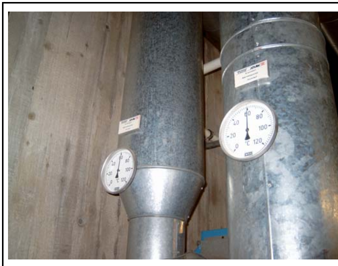
Bild 15: Vor- und Rücklauf des "Brennwert" - Wärmetauschers
